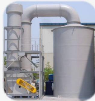
[Wet Scrubber(Turbo Fab)]
