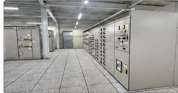
MCC ROOM 전기 PANEL
